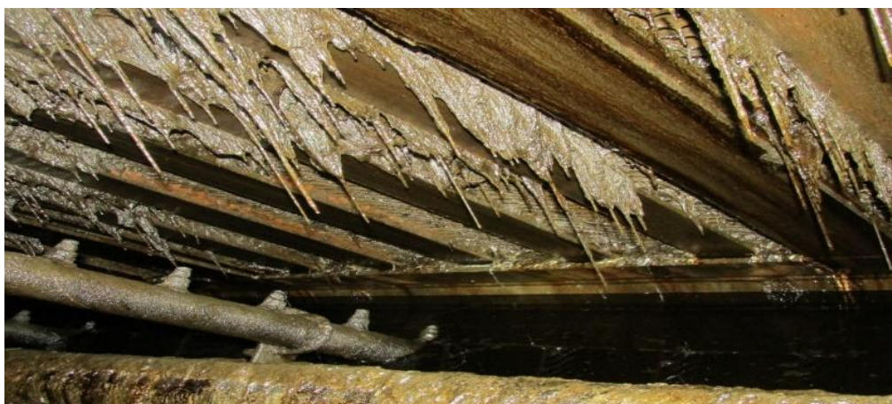
Рисунок 2. Фотография сепаратора первой ступени системы очистки МНСВ с колониями бактерий Figure 2. Photo of the first stage separator for the oil-and-oil water treatment system with bacterial colonies
